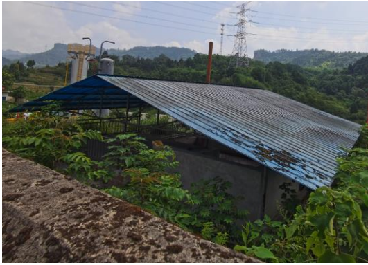
相9井废水池（防渗+加盖）
