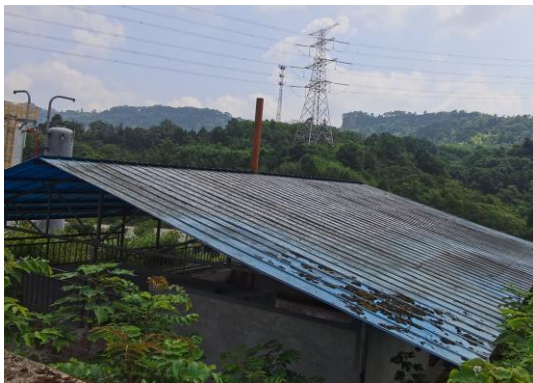
气田水池加盖+排气筒 (相 9 井)
